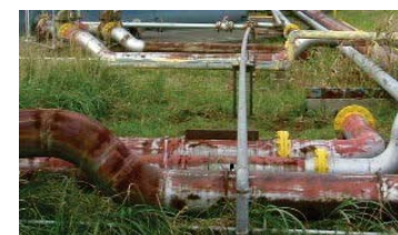
外面が錆びた危険物配管
